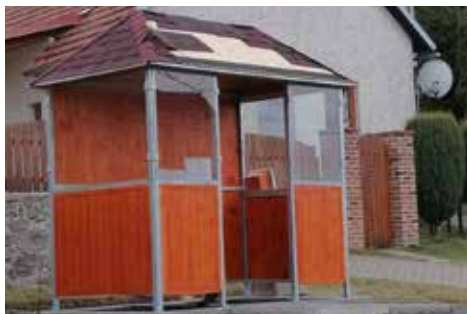
■ Mezi další škody silného větru můžeme zařadit střechu čekárny na autobusové zastávce v Jinošicích.
