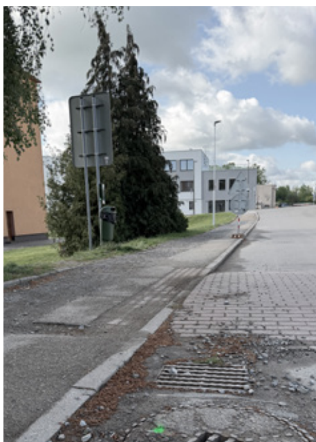
■ Stav chodníku a pozemní komunikace před rekonstrukcí povrchu
